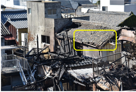
図 2-10 空き家の屋根瓦のずれ
