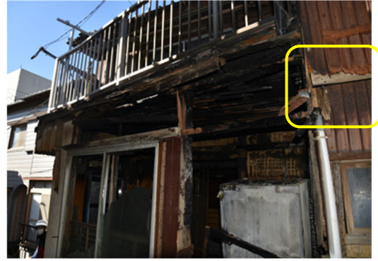
図 2-11 空き家の外壁の剥がれ
