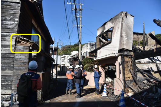
図 2-12 空き家の外壁の損傷
