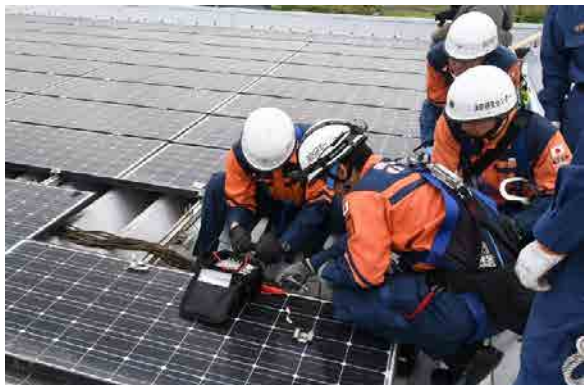
埼玉県行田市 太陽光発電設備火災 (令和6年5月)
