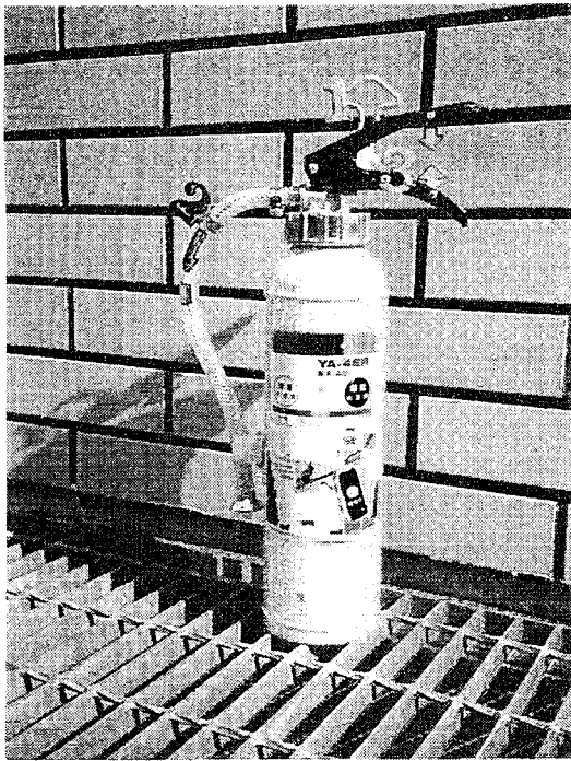
写真1 消火器操作要領の表示
