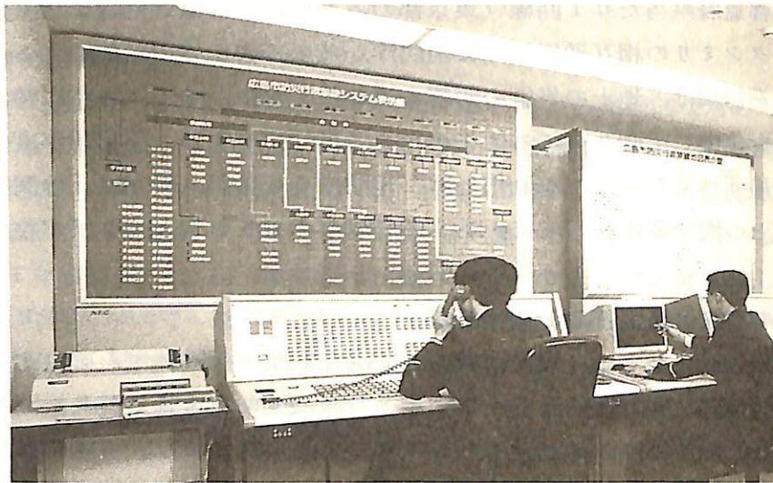
防災行政無線統制室(広島市消防局)
