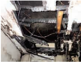
待合室の天井 (出火場所付近)
