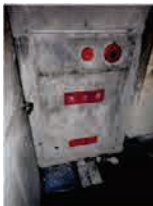
① 屋内消火栓設置状況
