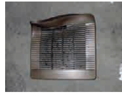
変形した換気口
