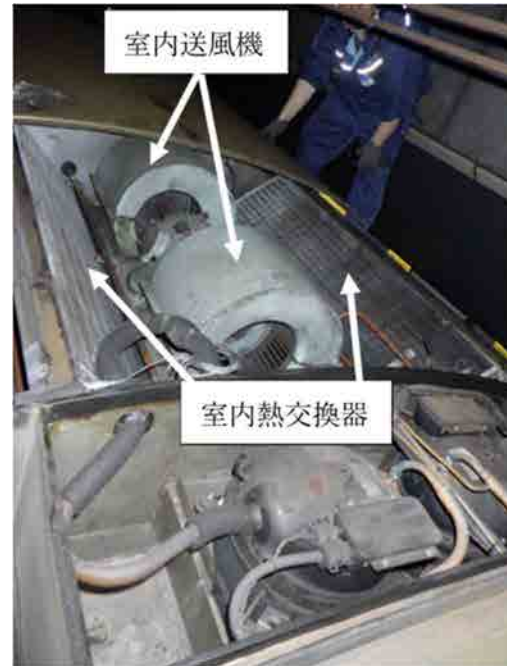
【写真2 クーラーユニット内部の状況】
