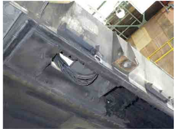
【写真9 クーラーユニット電力供給ケーブル及び断熱材の焼損状況】
