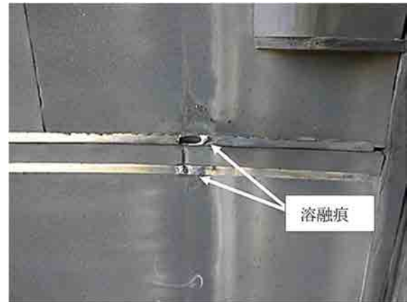
【写真7 クーラーカバー内面の溶融痕の状況】
