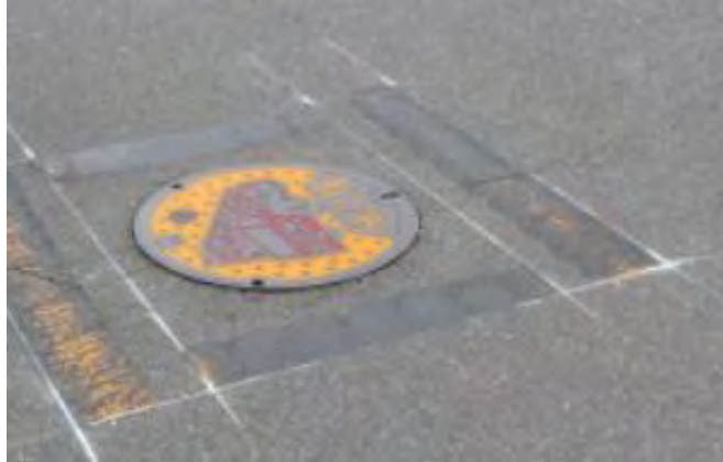
図 1.3 指定消防水利のペイントの剥がれ
