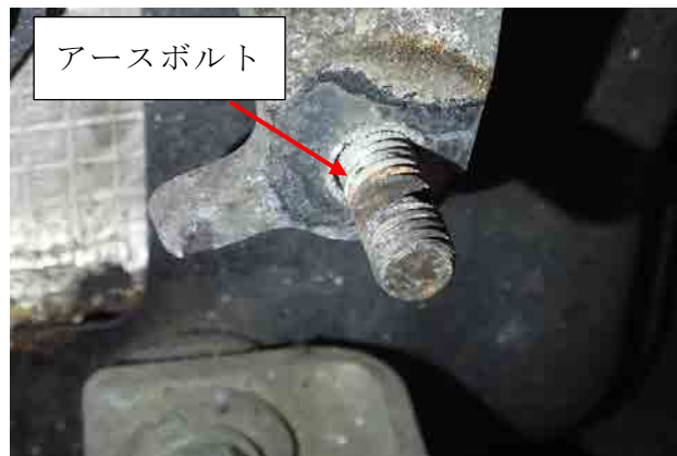
写真5 アースボルトの溶融状況
