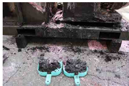
写真6 背面土台部の残渣物
