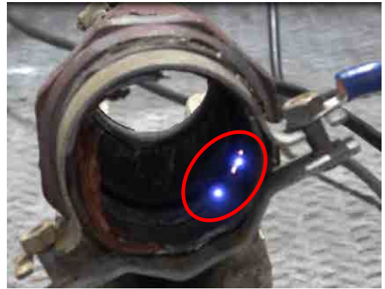
写真 11 通電試験による火花放電の状況
