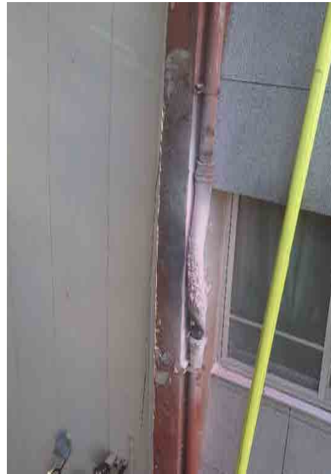
写真2 焼損した高圧ケーブル
