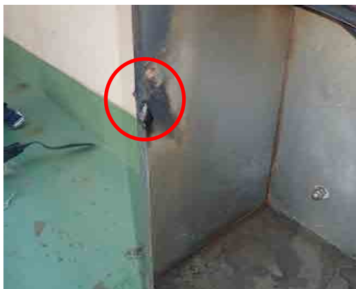
写真3 低圧用プルボックス内の状況
