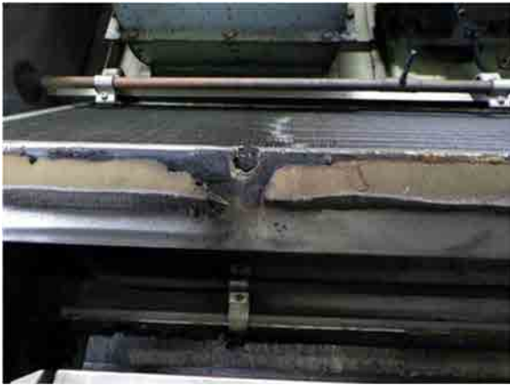
【写真8 熱交換器アルミカバー溶融痕及びパッキンの焼損状況】
