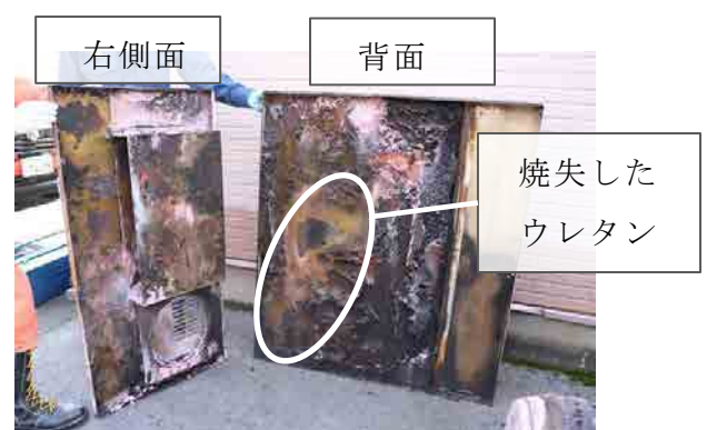
写真5 コンプレッサの内部
