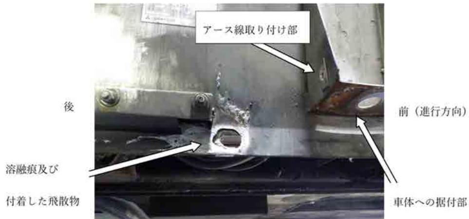
【写真 10 アース線取り付け部及びアース線付近の溶融痕の状況】
