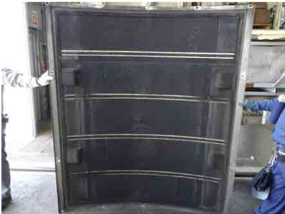
【写真6 クーラーカバー内面の状況】
