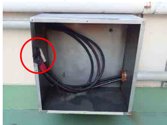
写真4 低圧用プルボックス内の電気配線の状況
