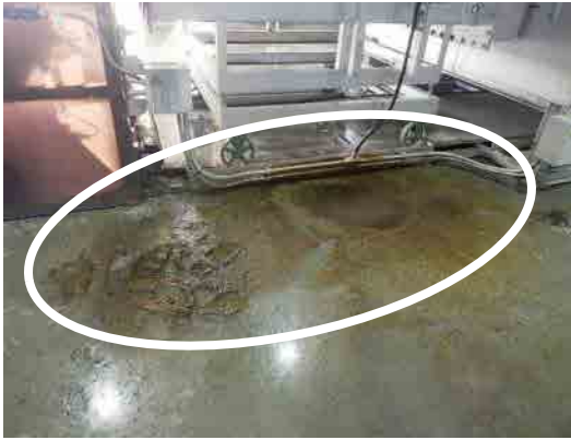
【写真 10 入口シール室横の固形物】
