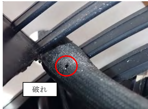
【写真15 同型品の破損状況1】
