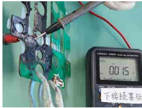
写真 21 下接続基板灰化箇所測定状況
