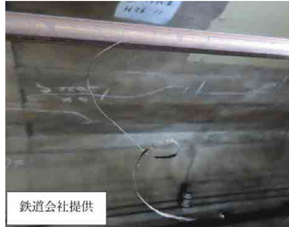
【写真 15 トロリ線から垂れ下がっているバリの状況】
