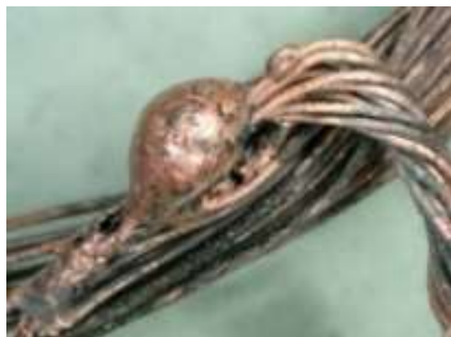
電気火災現場で見つかる溶融痕
