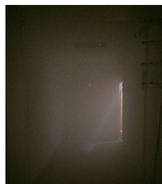
照明が不十分な廊下の例
