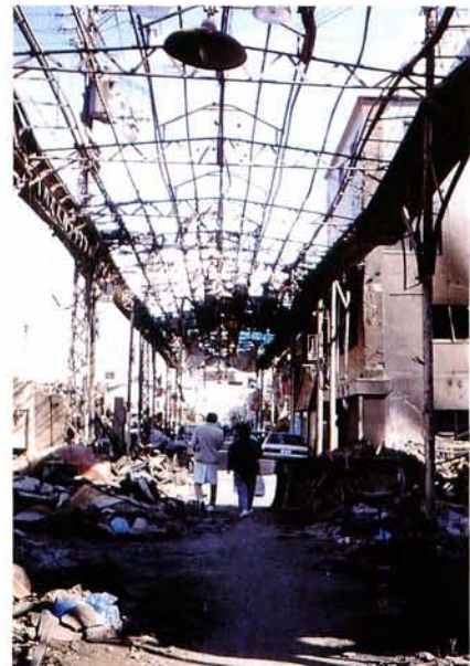
写真4 商店街において道路両側の建物は焼失し、アーケードの枠組みが残った。(長田区)
