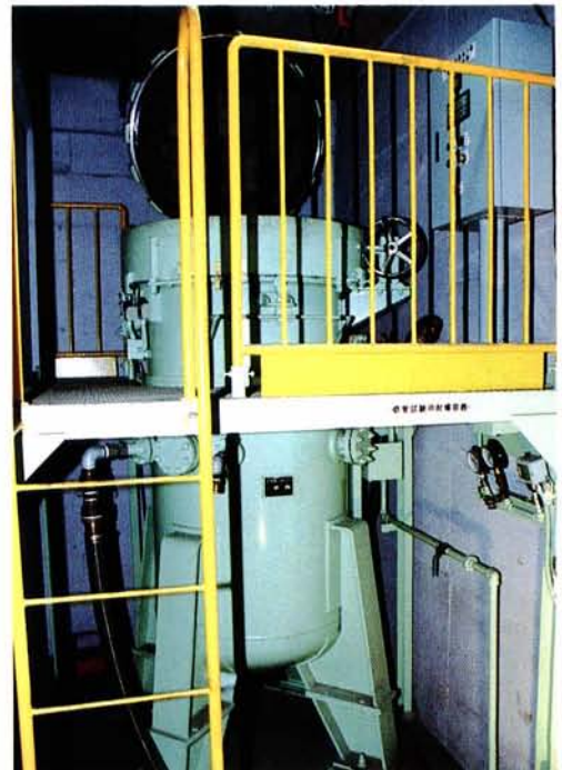
(5)耐爆試験装置の全景
